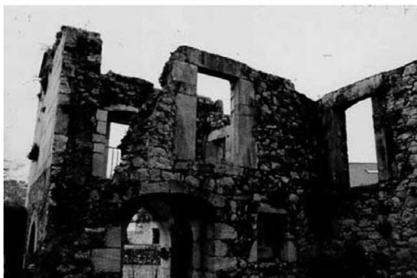
Vistas del interior del edificio y que evidencian la ruina.
